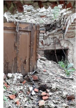
Vaade põhjast hoone idamahu sisemusse. Uks on mattunud ehitusprahi alla. (2018-08-26)
