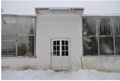
Kasvuhoone keskne sissepääs. Taastamisel ei ole järgitud ehitusaegset kujundust. Viilkatuse asemel on pultkatus ning lihtsustatud on välisukse kujundust. (2018-02-10)
