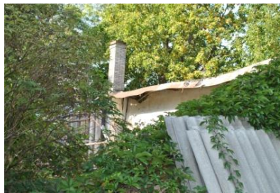
Vaade idast hooneosale, mis on vajunud sisse. Paeseinad on kaetud metsviinapuuga. (2018-09-08)
