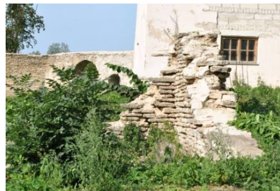
Põhja- ja lõunaosa vahesein on idaosas varisenud. Vaade lõunast. (2018-09-08)
